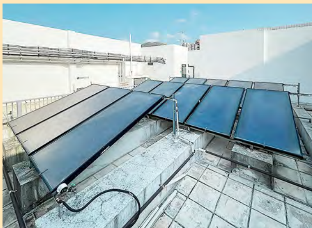
Solar panels 太陽能板
